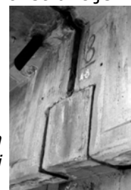
propadanje spoja na konstrukciji
