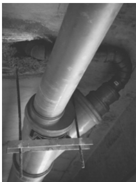
primjer lošeg rješenja odvodnje mosta
